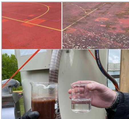
Sportplatzreinigung und dabei entstehendes Schmutzwasser, das mit der Anlage gereinigt wird
